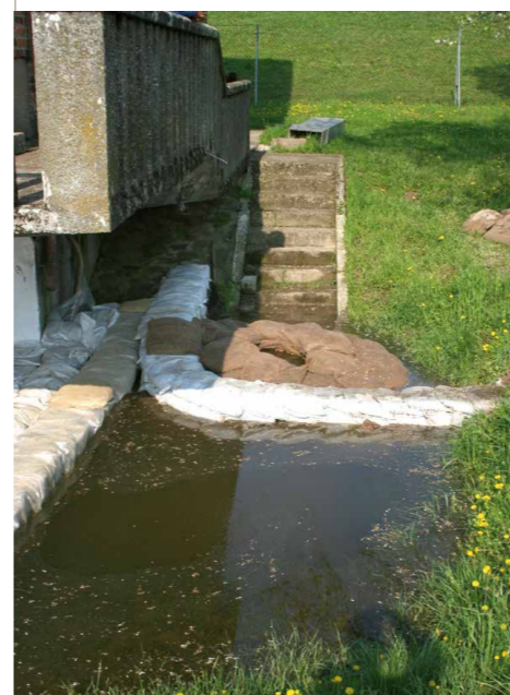
20. kép - Buzgár a Körtvélyesi szivattyútelepen
