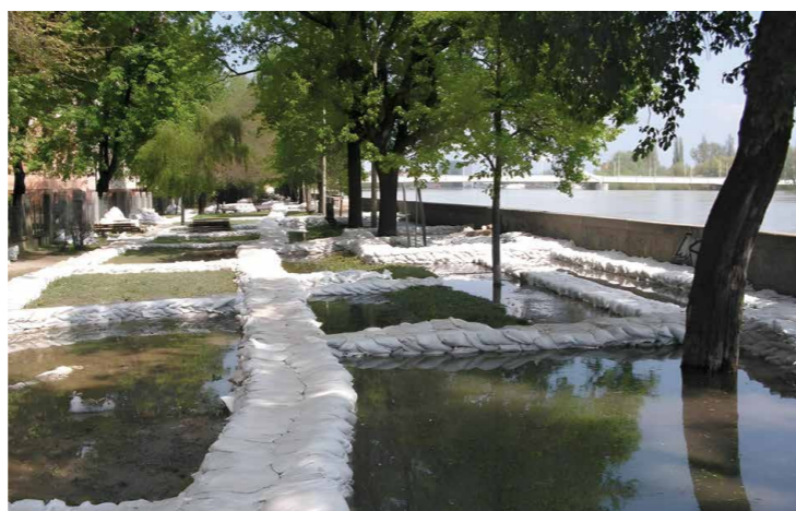
12. kép - Partfal alatti szivárgások miatt kiépített ellennyomó medencék
