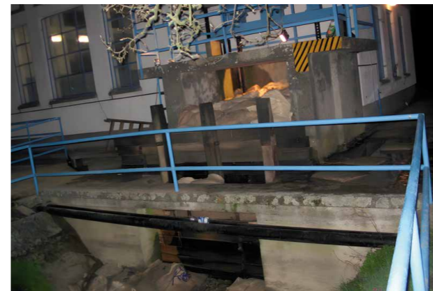
31. kép - A Makói szivattyútelep mentettoldali elzárásának meghibásodása
