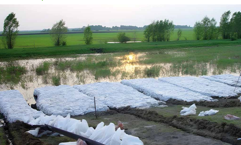
14. kép - Töltés mentett oldali rézsújének megcsúszása és stabilizálása
