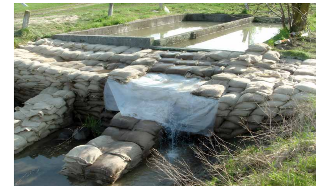
37. kép - A nagytőkei vízkivétel mentettoldali aknája
