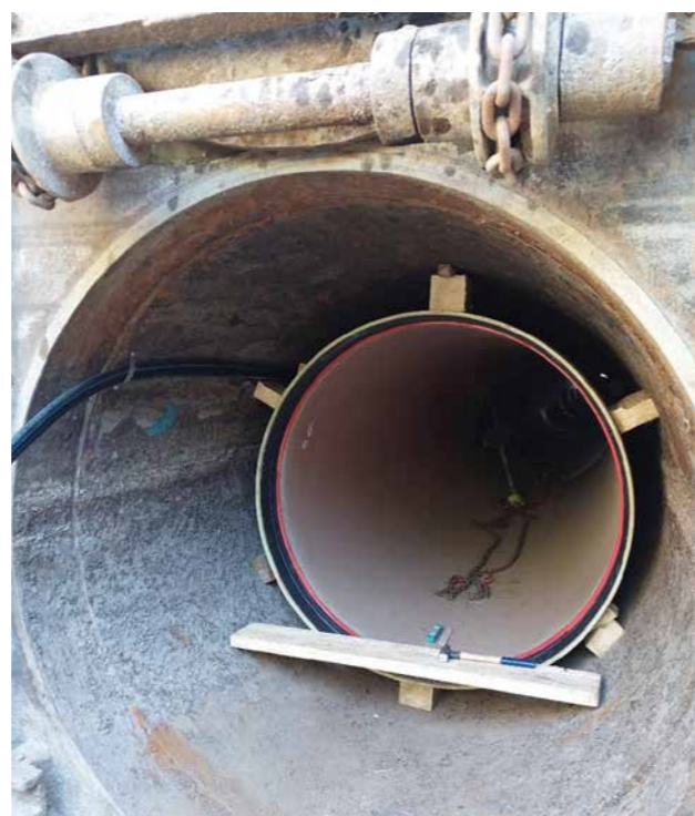
Györpölési szivattyútelep csőbélése
