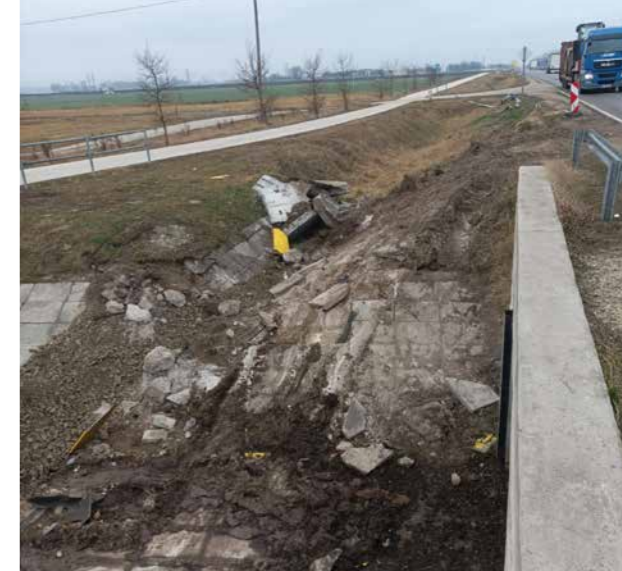
A baleset következtében összetört mederburkolat és oldalbeeresztő műtárgy
