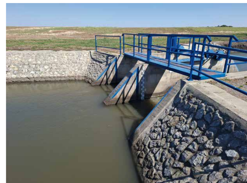
Klárai billenőtáblás tiltó A Kórógy-érből történt a víz biztosítása (Klárai tiltó közvetlenül a Klári átemelő felett)
