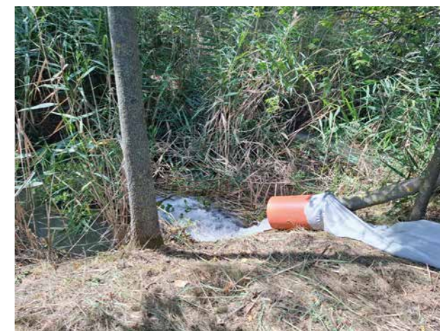
A VENERONI-val átemelt víz folyik a Kéktói főcsatornába
