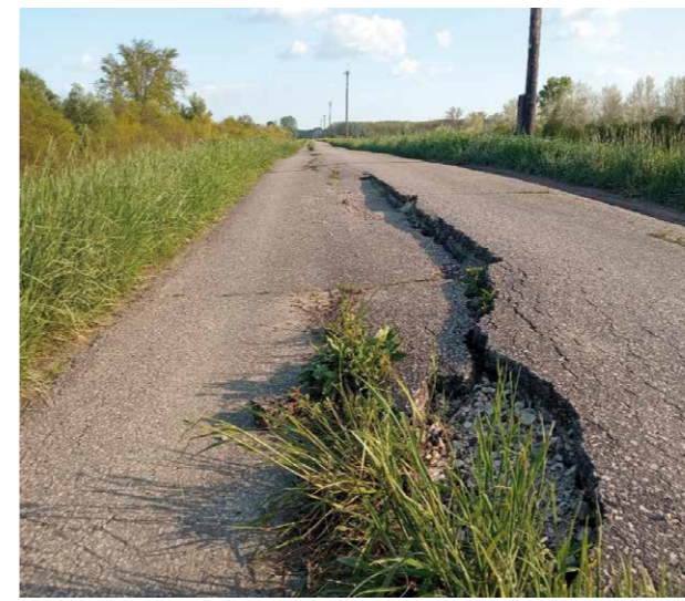
2. fénykép: Megsüllyedt aszfaltburkolat
