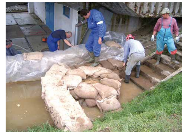
Buzgár a Körtevényesi szivattyútelepnél 2006-ban
