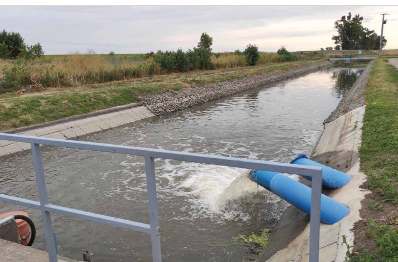
Cigányka-éri szivattyúállomás üzemelés közben
