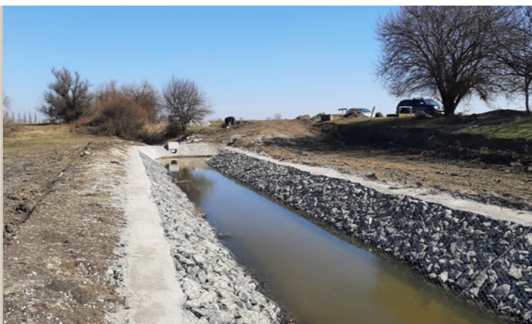
K-11 fenékürítő ök. csatorna
