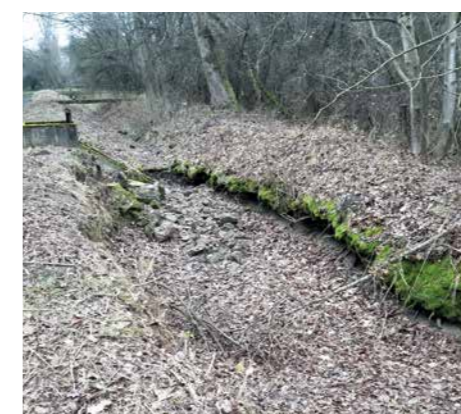
Levelényi-csatorna helyreállítás előtt
