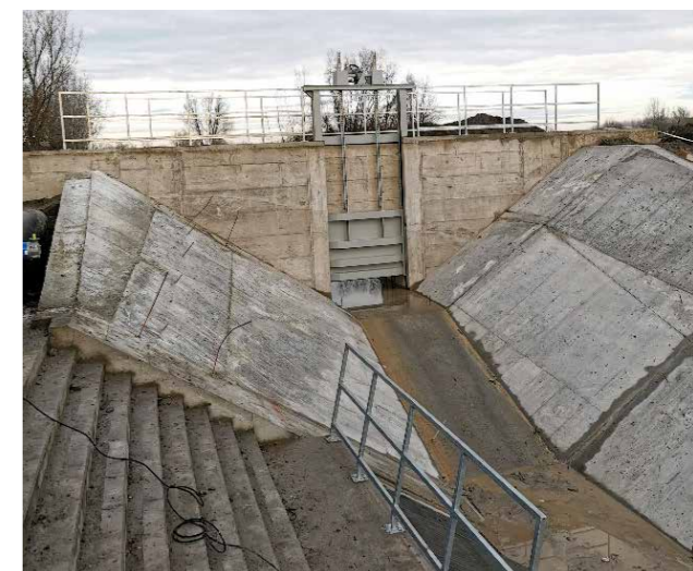
Ivánszéki szivattyútelep szivótere
