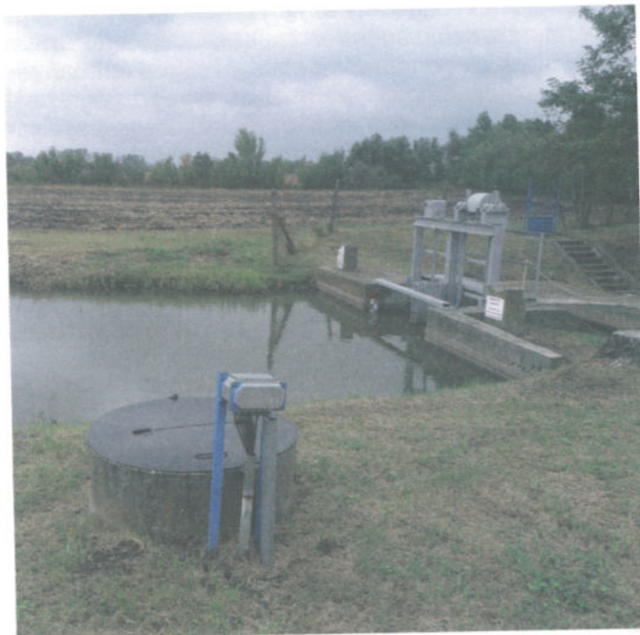
A Ludas-ér megújult torkolati műtárgya
