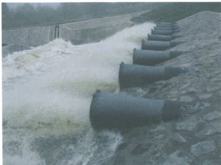
Sikeresszivattyúpróba az új árvízkapunál
