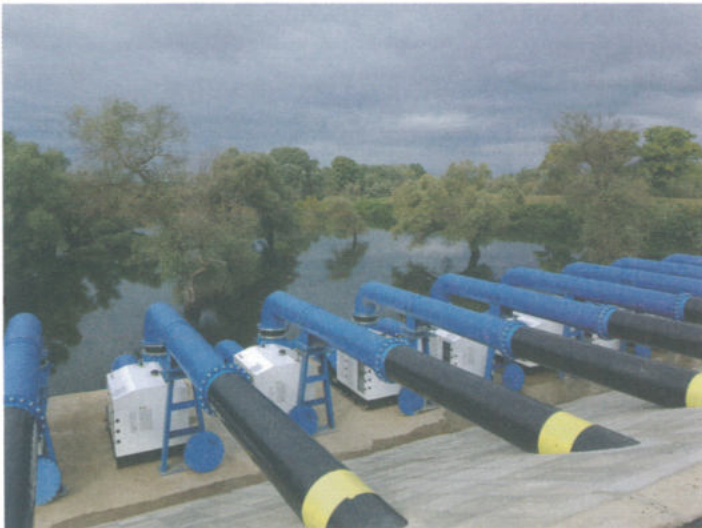
Mobil szivattyúállás a Dong-ér torkolatánál
