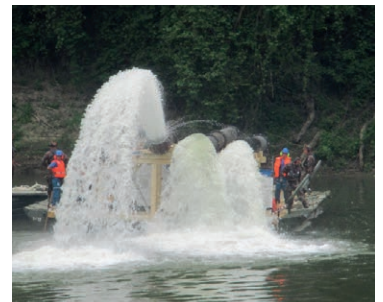
Az üzemelő mobilszivattyúk
